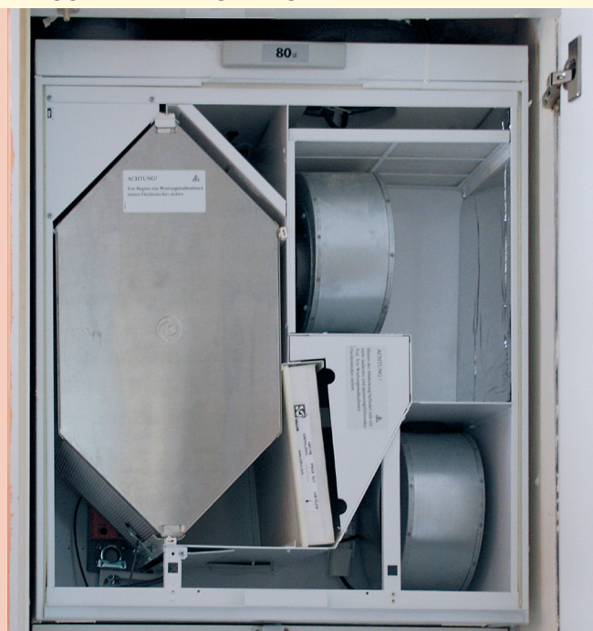
Lüftungsgerät mit Wärmerückgewinnung
